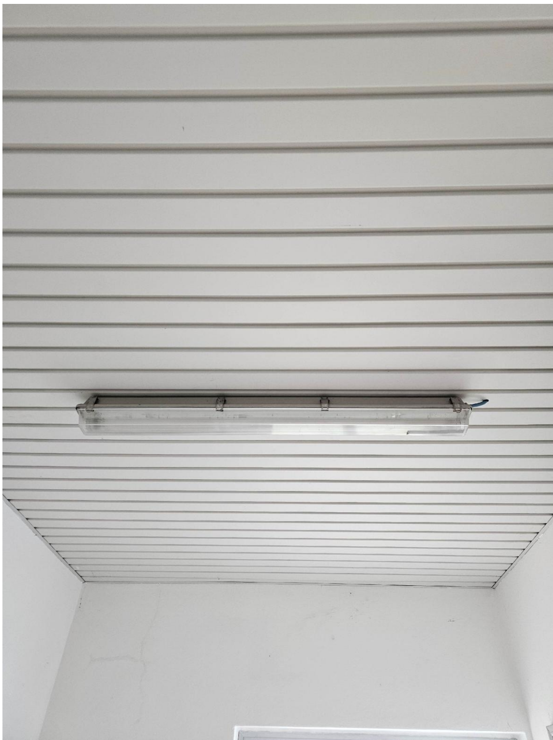
Foto 11 - vista interna: illuminazione
