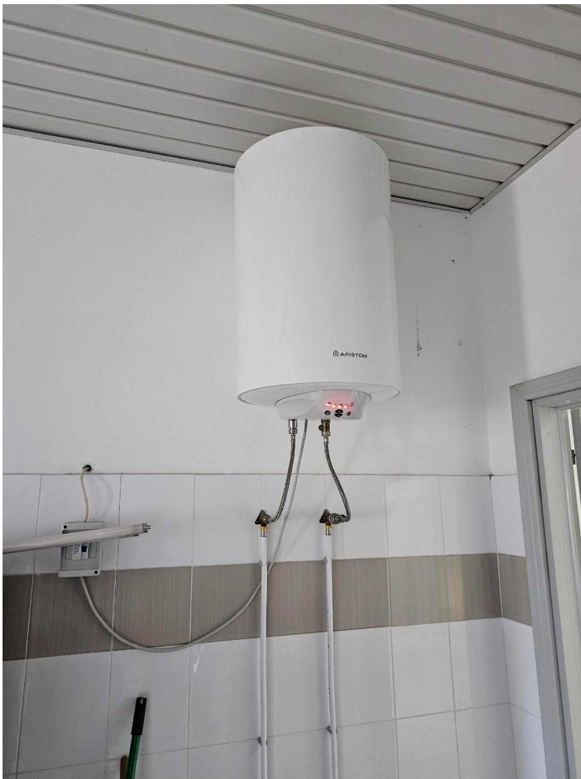
Foto 13 - vista interna: scaldabagno puntuale
