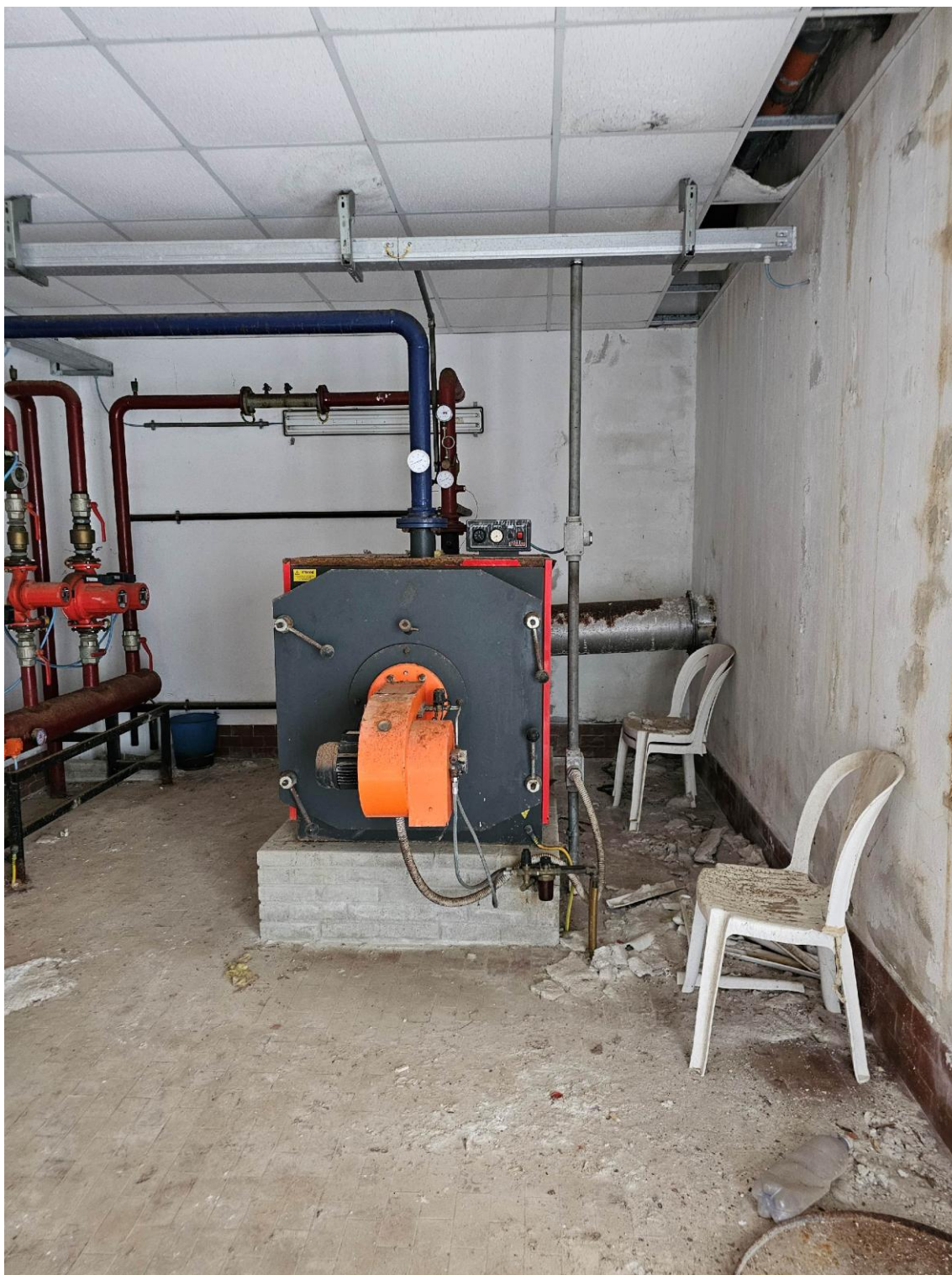
Foto 21 – locale tecnico: caldaia
