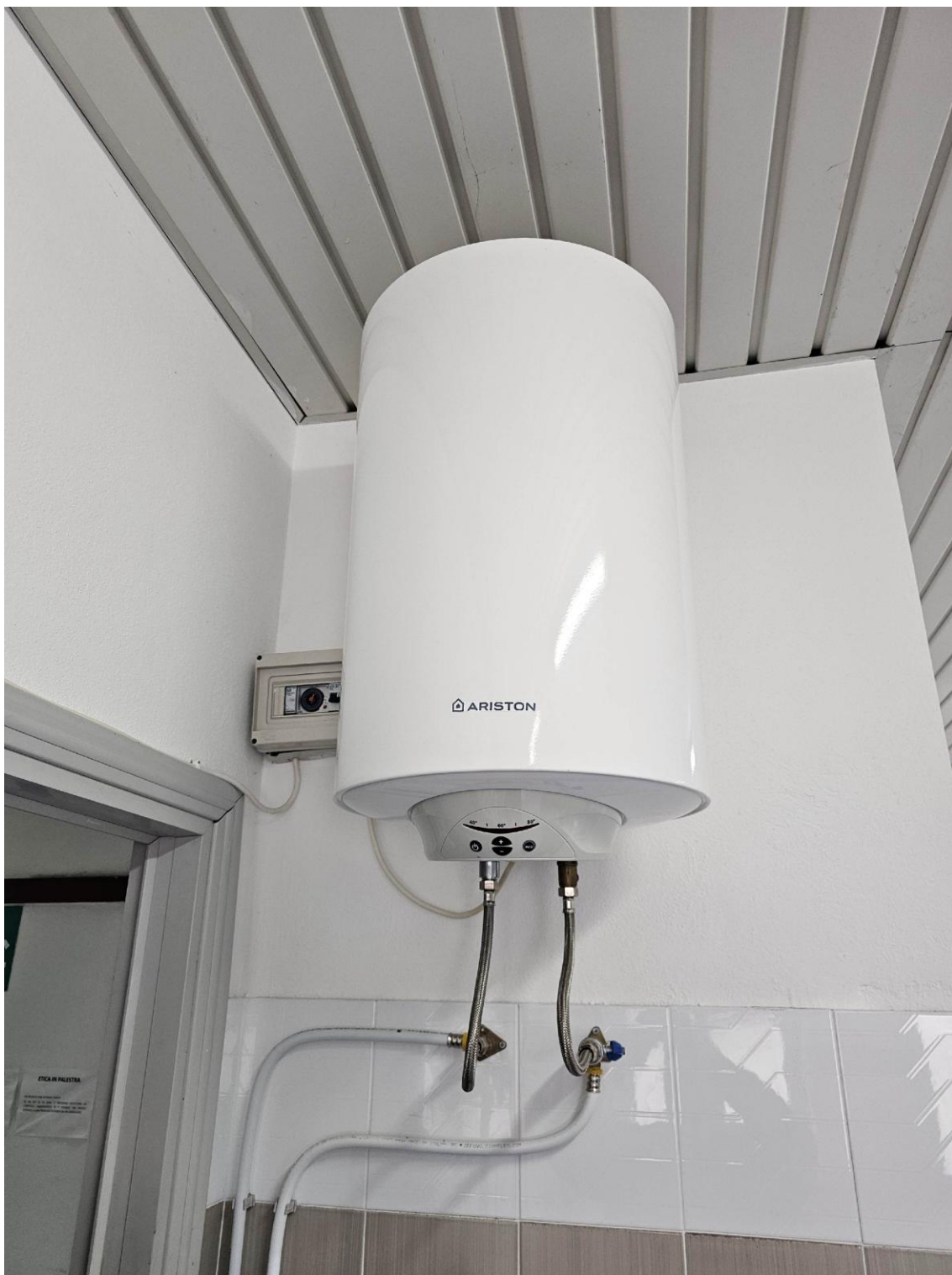
Foto 16 - vista interna: scaldabagno puntuale
