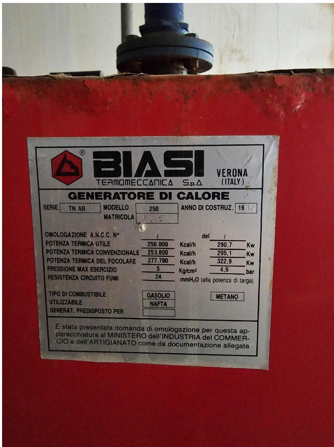
Foto 22 - locale tecnico: targa caldaia
